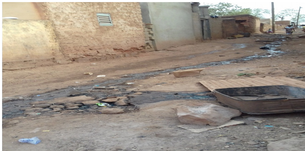
Photo 1 : une canalisation dé fortune à Sabalibougou
